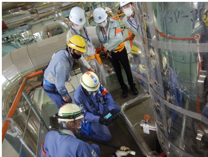
美浜発電所起動工程点検の様子
