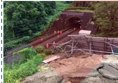
新幹線近くの斜面上部に設置された太陽光発電施設が崩落した事例
