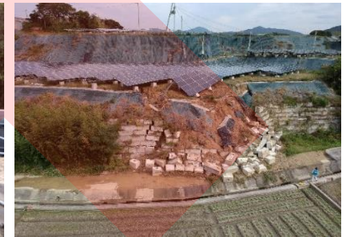
法面保護工が崩れて流出した事例
