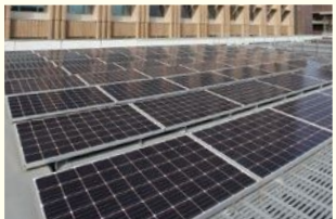
太陽光を庁内電力に活用
