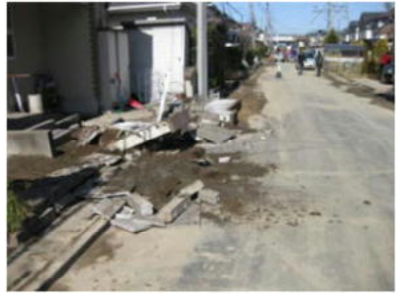
久喜市内被害状況(側溝が壊れ、土砂が流出)
