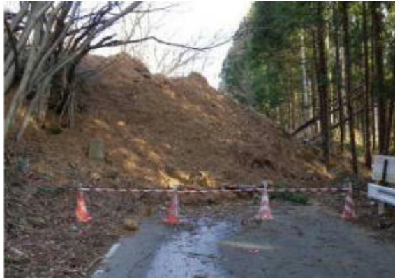
宮城県村田町内(震度5弱)県道の被災状況 (土砂崩れが発生し通行止め)
