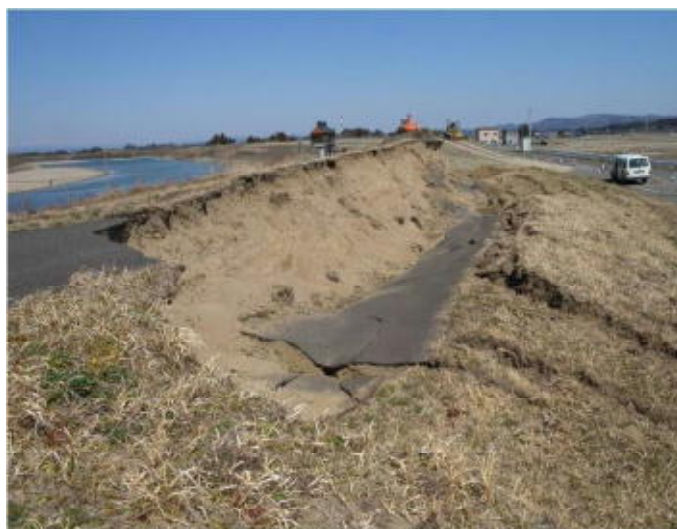
東日本大震災による堤防の被害状況（宮城県角田市）
