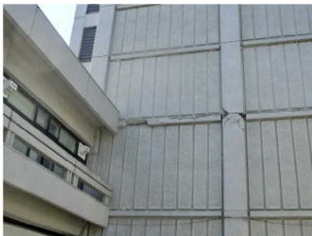
【東北大学 校舎 柱被害】
