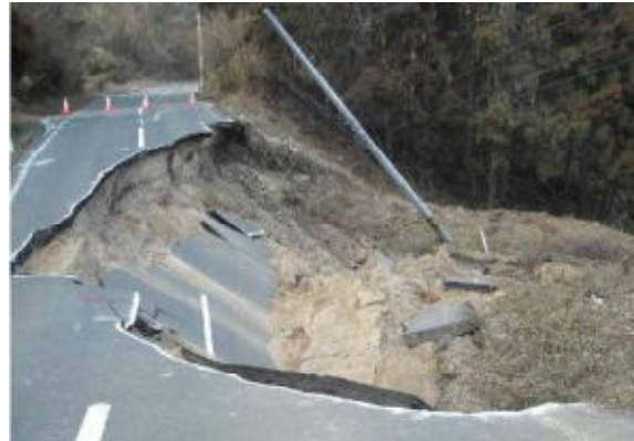
宮城県大崎市内(震度6弱)県道の被災状況 (道路盛土が崩壊し通行止め)
