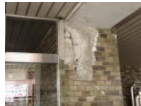
柱頭の損傷状況
