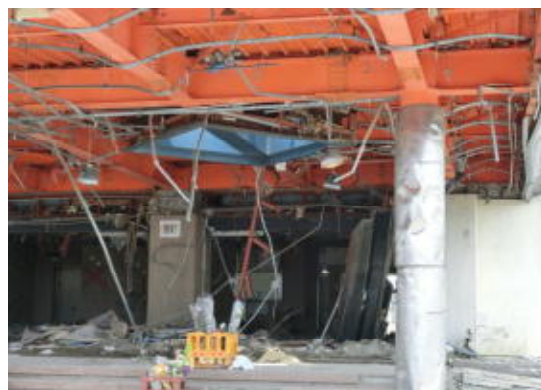
岩手県陸前高田市役所の被害状況 ( 1 階部分 )
