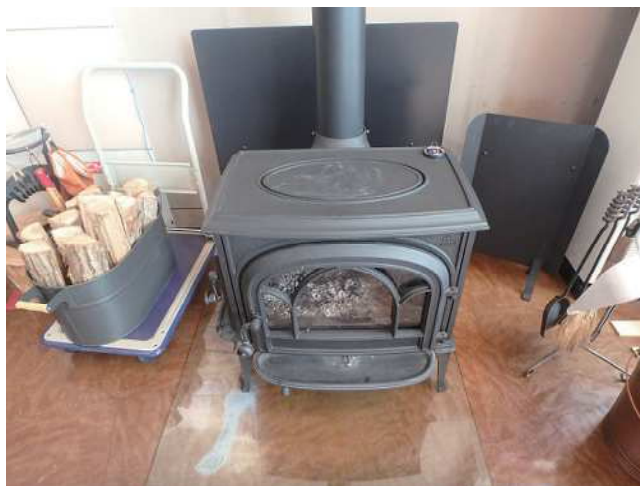
自動車販売店のショールームに導入された薪ストーブ(高山市)
