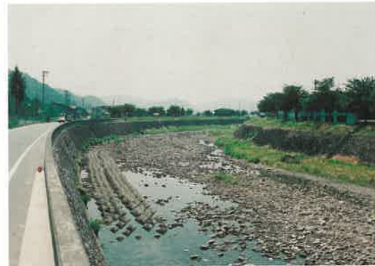
平成6年8月の濁水状況(飛騨市古川町片原町、古川小学校前)
