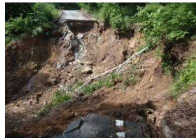
林道被害（飛騨市）
