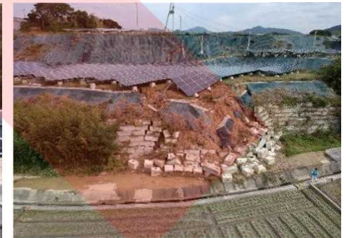
法面保護工が崩れて流出した事例
