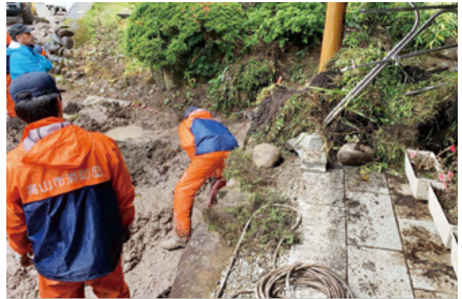
民家に流入した土砂の撤去 (高山市)
