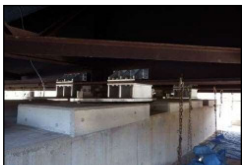
変異制限装置の設置
