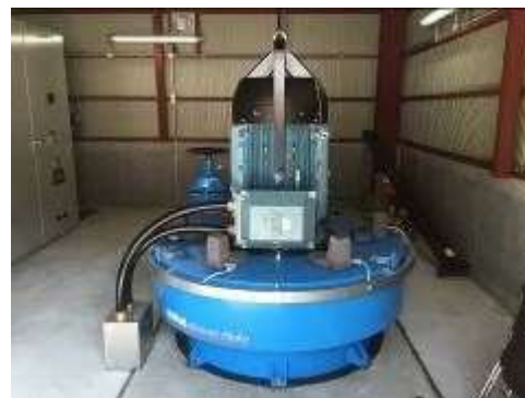
水車・発電機
