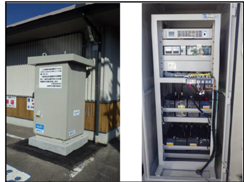
蓄電・配電装置
