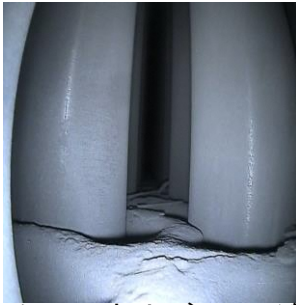
SG器内のスケールおよびスラッジの残存状況 (B-SG 第1管支持板上)
