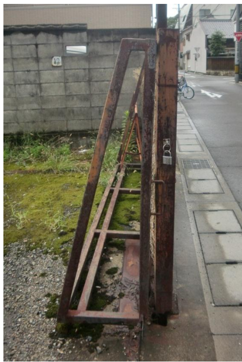
現場写真①: 出入口の扉の腐食 平成 25 年 9 月撮影
