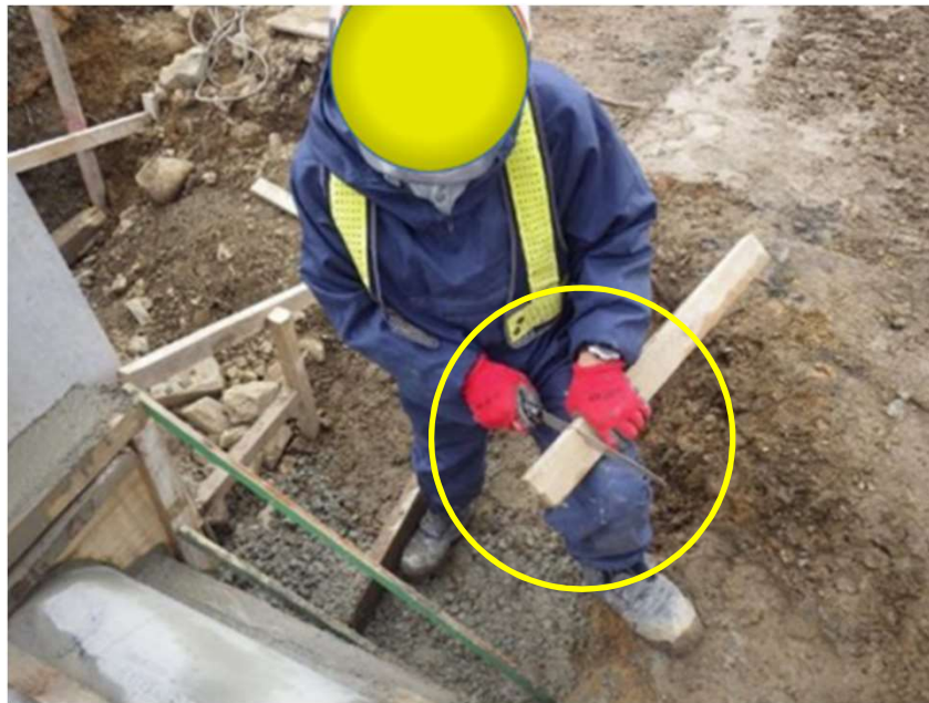
事故再現状況写真
