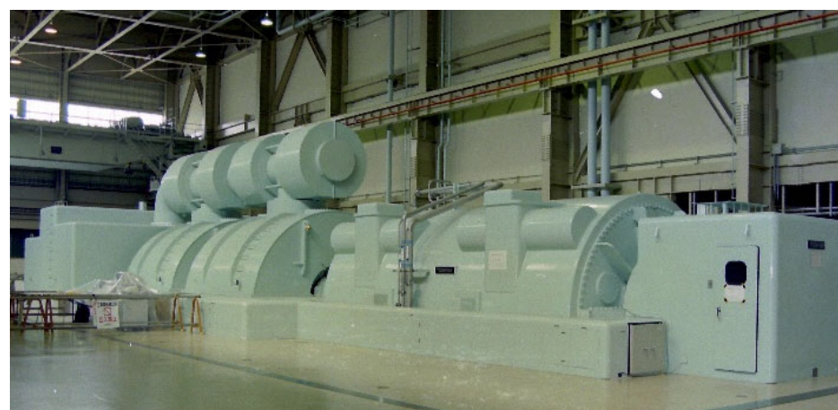
タービン発電機（タービン建物3階）
