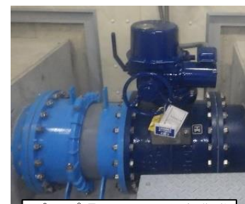
ポンプ場のリモート制御化 （土岐市内）
