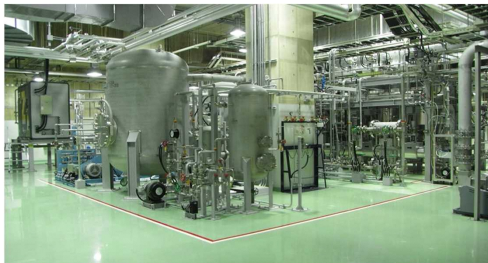
排気ガス処理システム
