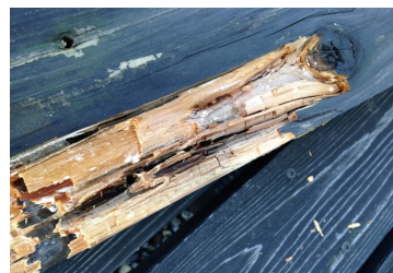
デッキ材の腐朽 (生物劣化)
