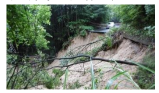
⑨ 林道恵南線／路体崩壊 (恵那市上矢作町)
