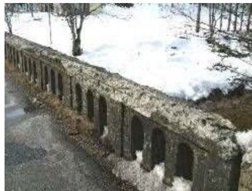
高欄天端がスケーリングしている状況
