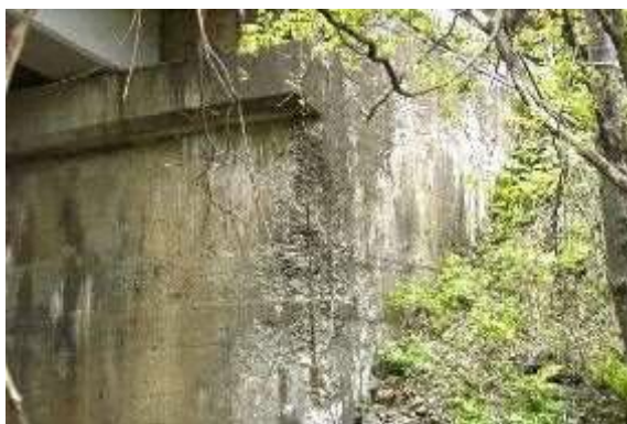
橋台端部が断面欠損している状況
