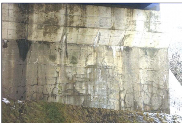
橋台に発生したひび割れ（飛騨地域の事例）
