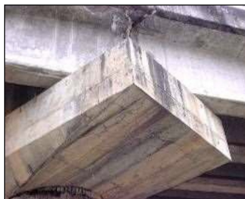
橋脚に発生したひび割れ（東濃地域の事例）
