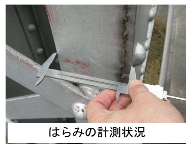
健全部・腐食部ではらみ計測
