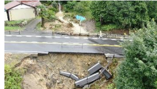
⑥ 国道19号／路側崩壊 (中津川市落合)
