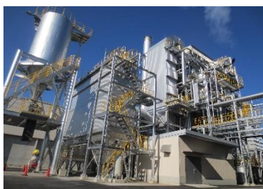
木質バイオマス発電施設（瑞穂市）
