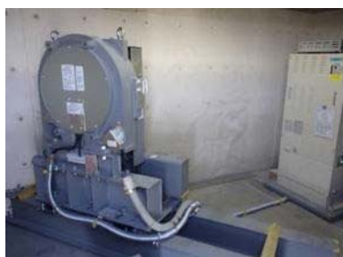
巻上機、制御盤
