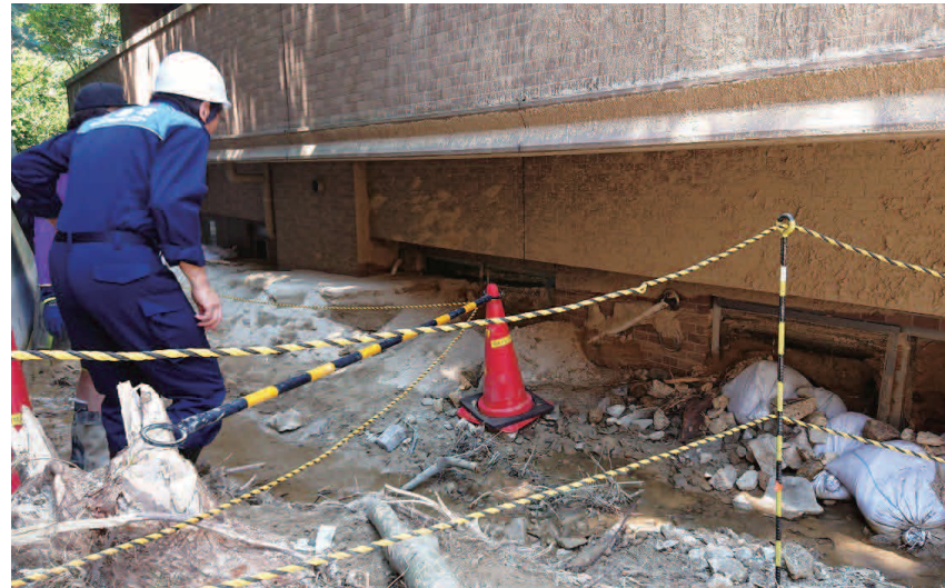
土砂災害により1階部分が埋まった家屋 平成30年7月豪雨災害(広島県海田町) 写真提供:広島県海田町
