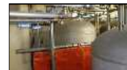
[劣化重水貯槽及び重水貯槽用拔出槽]
