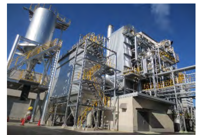
木質バイオマス発電施設（瑞穂市）
