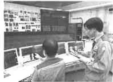
①デジタル制御盤での監視・操作
