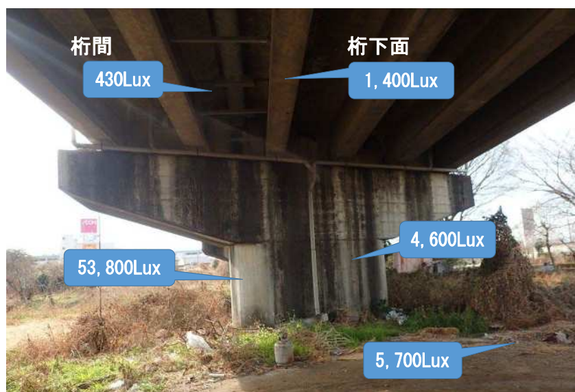
付録3-図3.1 ポステンT桁橋下面の照度計測値
