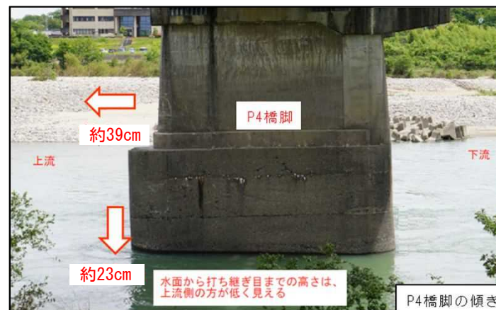
【下部工の損傷】
