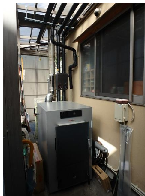
宿泊施設に導入された薪ボイラー（関市）
