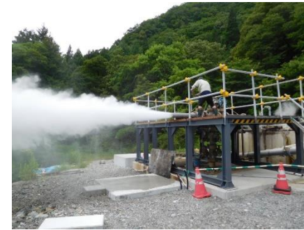
↑ 奥飛騨第二バイナリー発電所
