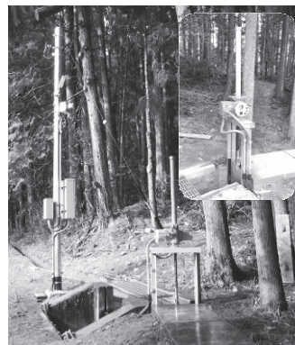
ゲートの遠隔監視・操作
