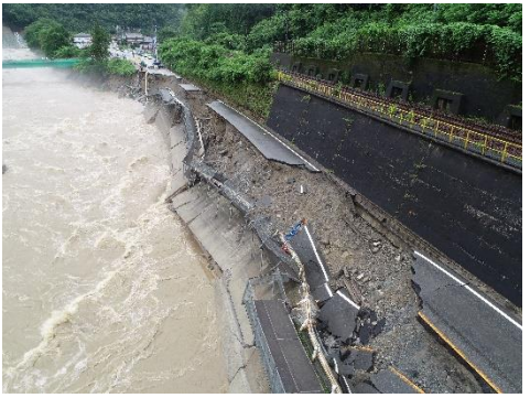
令和2年7月豪雨(下呂市:国道41号) 写真提供:高山国道事務所
