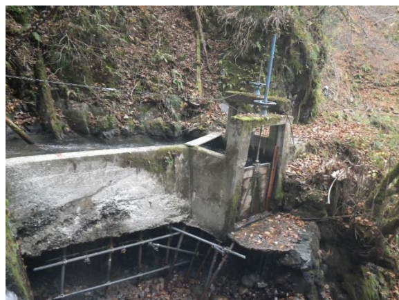
老朽化した用水施設
