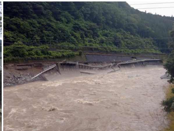
図 6-16 令和 2 年 7 月豪雨災害 (下呂市小坂町門坂地内 国道 41 号道路崩壊状況)
