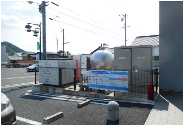
純水素型コージェネレーション燃料電池システム 八百津町防災センター
