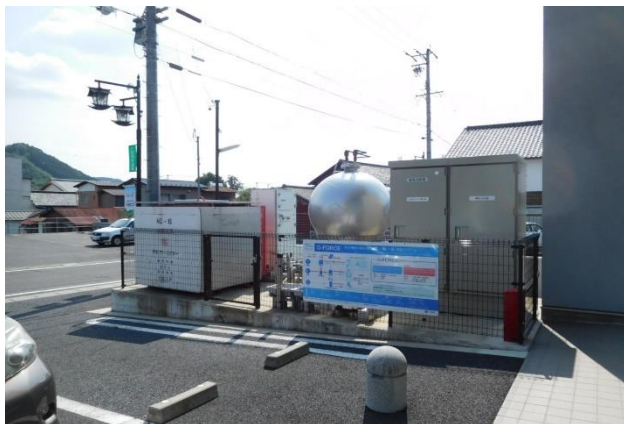
純水素型コージェネレーション燃料電池システム 八百津町防災センター
