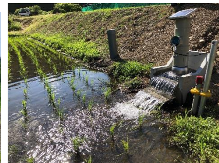
自動給水栓の実証(岐礼地区)
