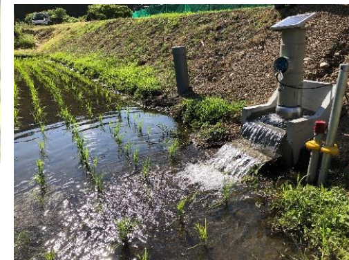
自動給水栓の実証(岐礼地区)
