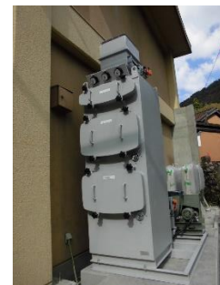
(写真6-1) 陽圧化装置
