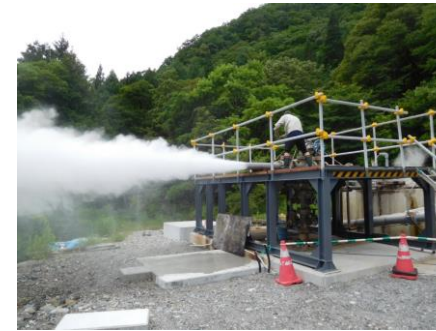
↑ 奥飛騨第二バイナリー発電所
