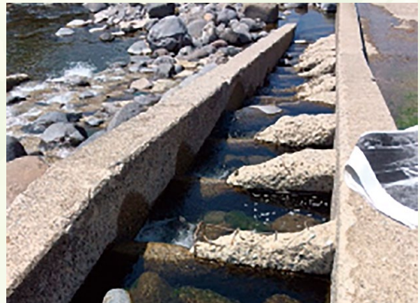
鉄筋が露出した魚道 【牛道川(郡上市)】
