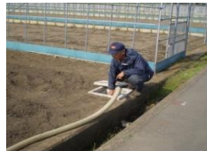
給水栓の操作状況
