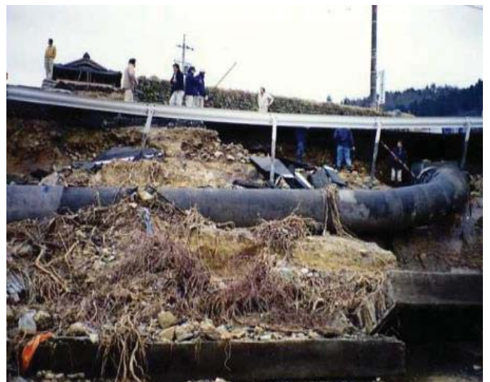
平成6年の水道管破断事故 （瑞浪市）
