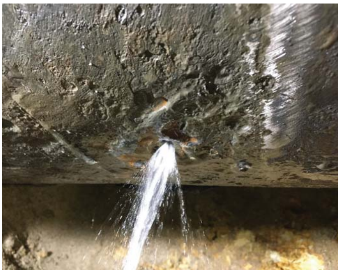
劣化する水道管の漏水事故 （経年劣化の進行）
