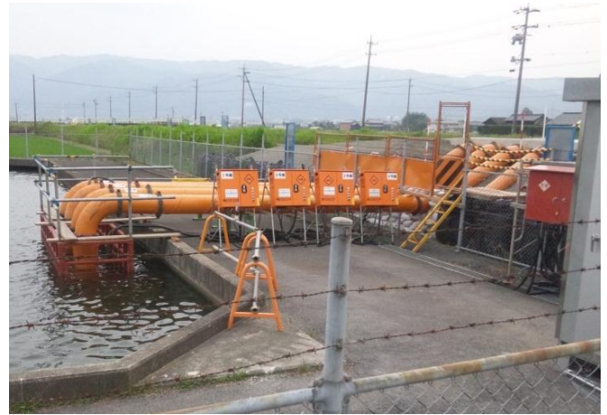
写真-2 専用ポンプ施設
