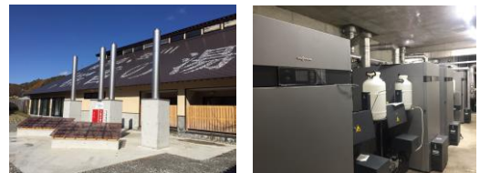
<温泉施設ボイラー(高山市)>
