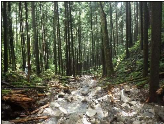
土石流センサー設置状況（大ヶ洞・下呂市萩原町地内）
