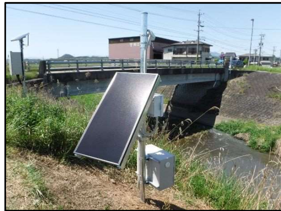
簡易型河川監視カメラ (蜂屋川 美濃加茂市)
