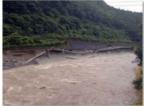
下呂市小坂町門坂地内 国道 4 1 号 道路崩壊状況
