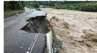
①路側崩壊 (高山市・国道471号)
