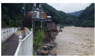
⑤護岸崩壊 (下呂市・飛騨川)
