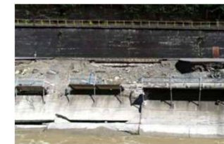
⑨鉄道被害 (下呂市)
