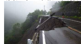
③路側崩壊 (高山市・乗鞍公園線)
