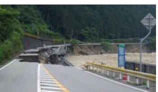
⑦道路崩壊 (下呂市・国道41号)
